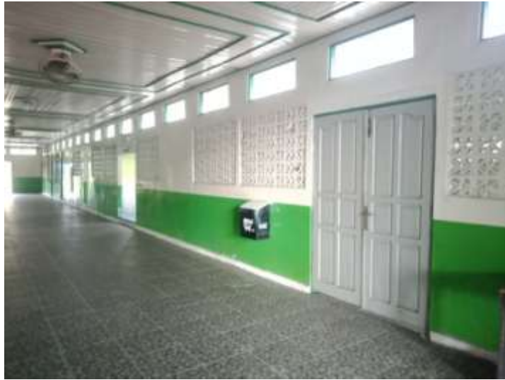
WC Dan Kamar Mandi Di Masjid Jami Teluk Tiram
