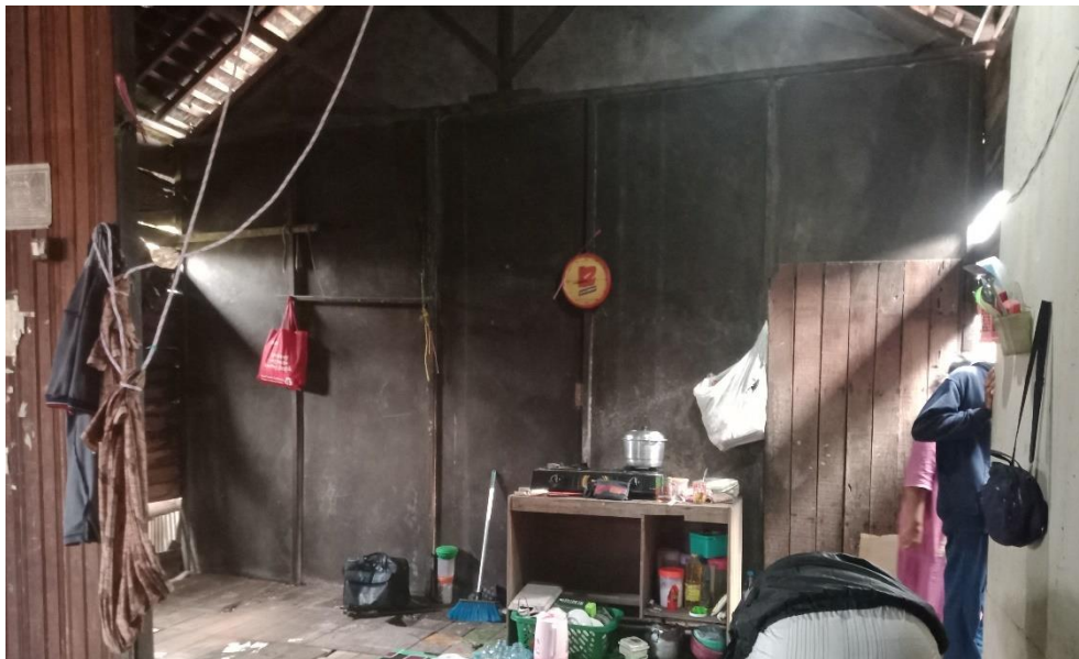
Kondisi Rumah Bapak Abdul Hadi Sebelum di Bedah
