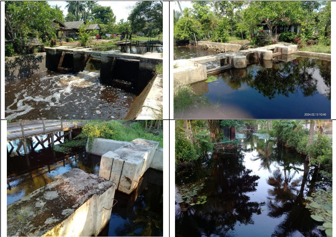
Tabat atau bendungan kecil di handil pada Desa Rumpiang Kec. Beruntung Baru Kab. Banjar Provinsi Kalimantan Selatan
