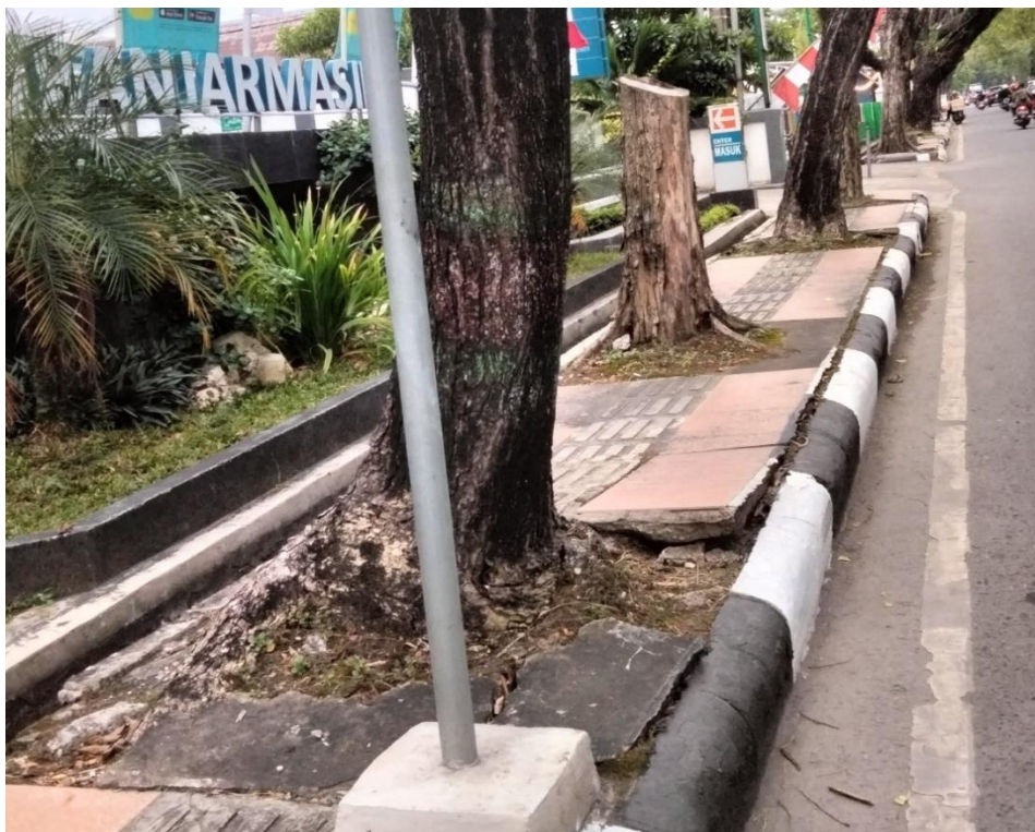
Kondisi Trotoar yang Rusak
