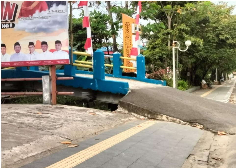
Trotoar yang Belum Memenuhi Standar
