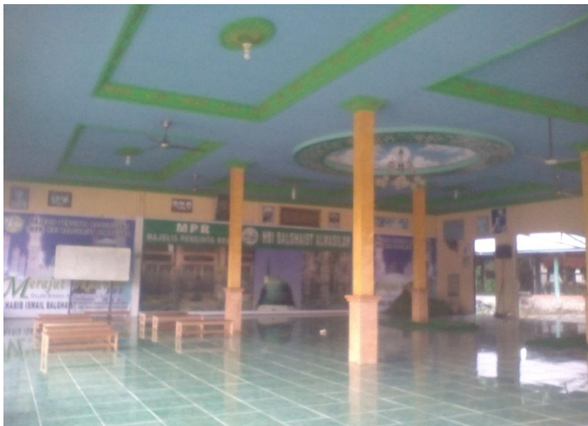
Kondisi bangunan Majelis Taklim al-Wasilah dilihat dari dalam
