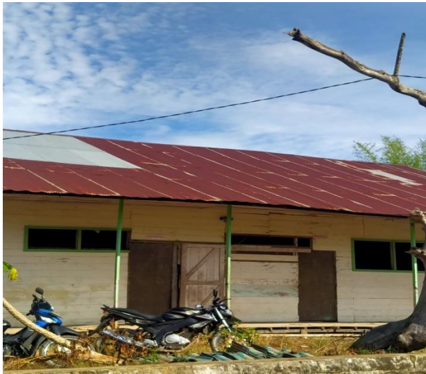
GAMBAR 4.4 Bangunan kelas yang masih belum bisa diperbaiki
