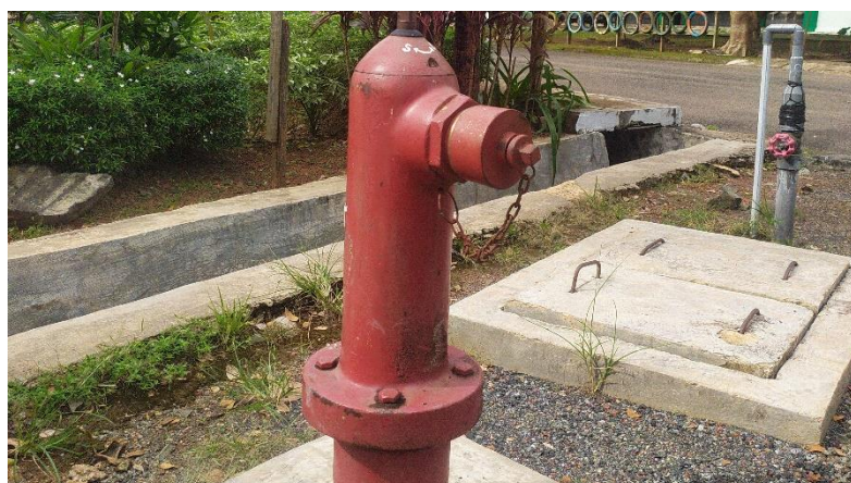
Hydrant Pemadam Kebakaran
