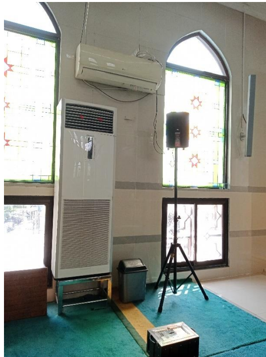
Gambar 4. 25 Salah satu AC di sudut ruang Masjid Al-Jihad
