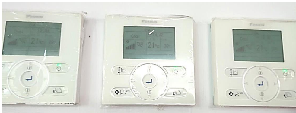
Gambar 4.1 Pengaturan AC pada Ruangn Perpustakaan Kampus II
