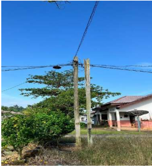
Dokumentasi tiang listrik diperumahan PT Singaland
